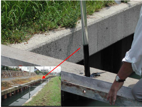
吸い込み口付近のヘッド 減少傾向 悪臭 無くなる
