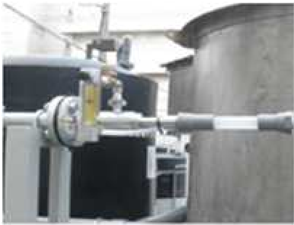
浮上分離槽の加圧タンク入口に設置
