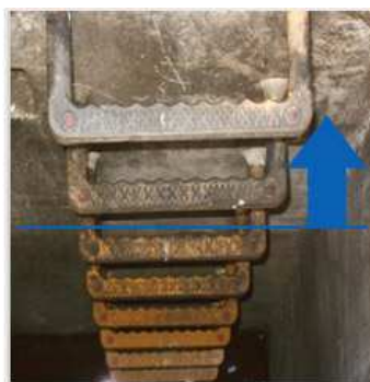
マイクロナノバブル設置時に浸漬していない部分は、表面の汚れが目立っています。
